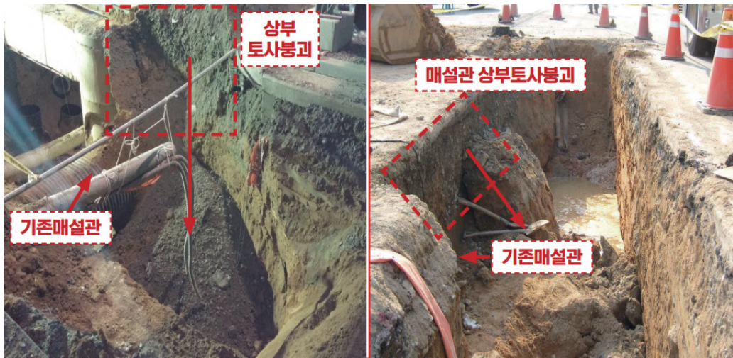
상부 되메움토 붕괴
