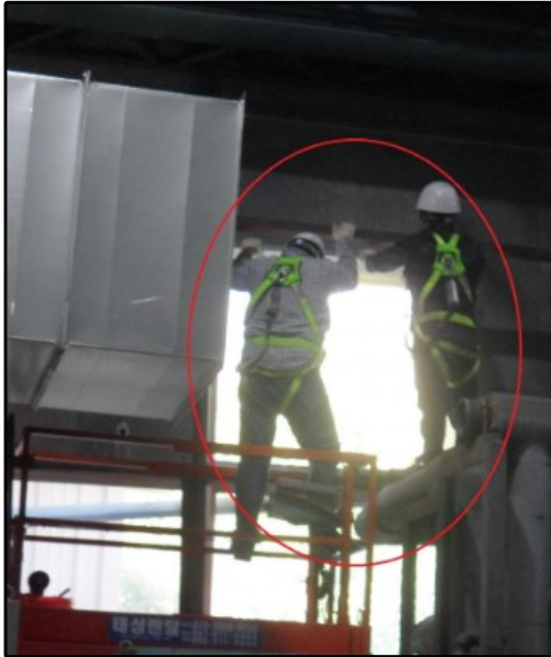
산소공장 덕트 연결 작업중 안전 걸이를 하지 않고 작업
