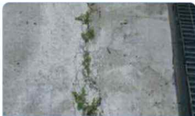
개선 전 - 바닥 파손
