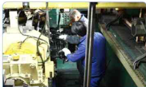
정비·보수 작업시 오조작
