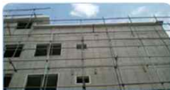
비계 단부 작업발판 및 안전난간 미설치
