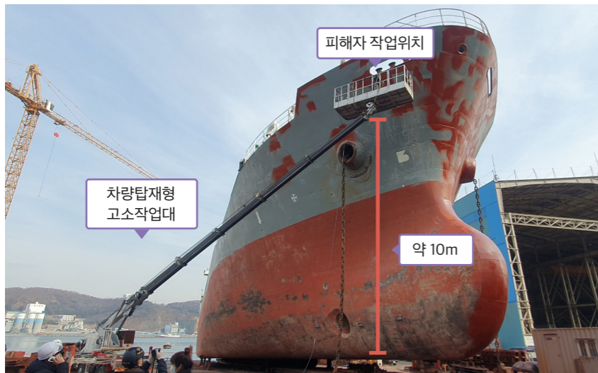
재해자가 오전 그라인딩을 한 작업 위치
