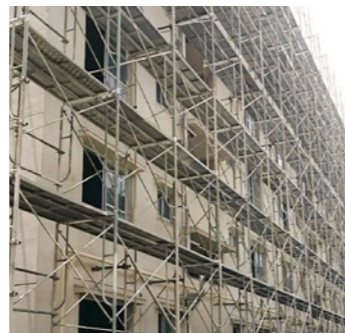
강관 틀비계(Frame Scaffold)
