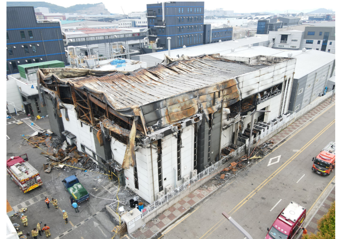
화재 발생 22시간 만에 진입된 A기업 공장
