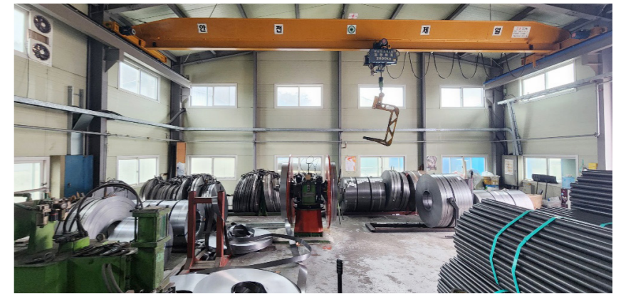
2019년 6월 설치한 천장 주행 크레인과 C형 후크
