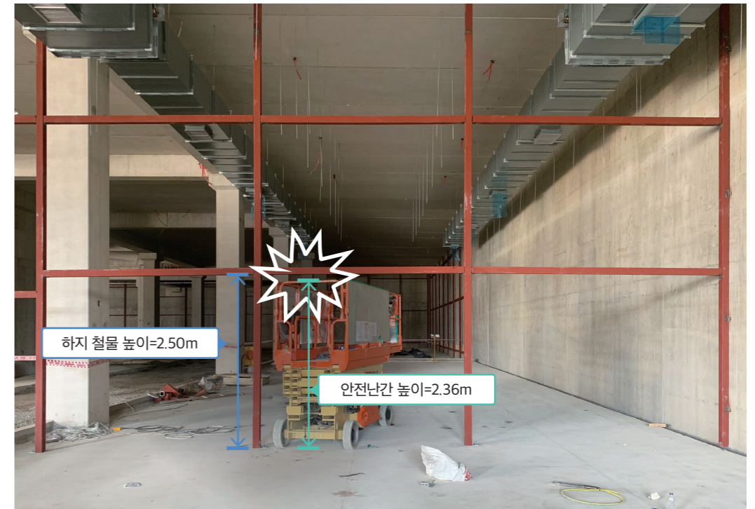
사고가 발생한 현장
