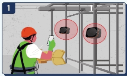
1 양생작업 전 양생공간 내부에 일산화탄소 감지기 설치 (면적을 고려하여 양생작업 내부에 최소 2대이상 설치)
