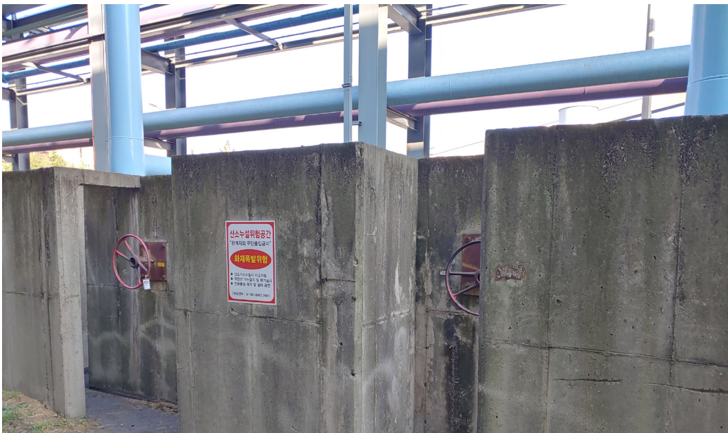
방호벽 바깥쪽에 설치된 조작 핸들
