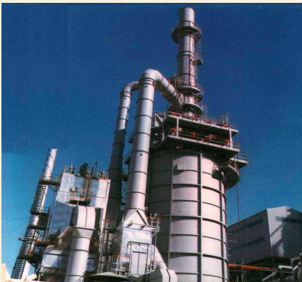
가열로가 설치된 모습
