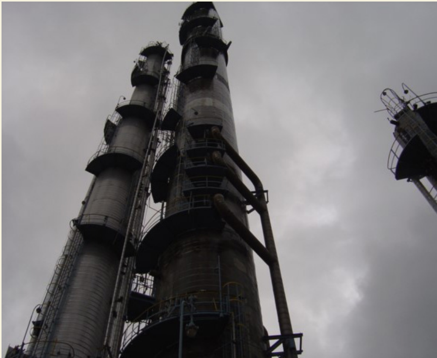
실제 현장에 설치된 증류탑의 모습
