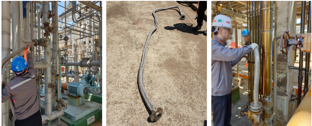
3번 증류탑(DA.3) 하부와 혼합잔사유 저장탱크를 임시 배관으로 연결한 모습과 임시 배관
