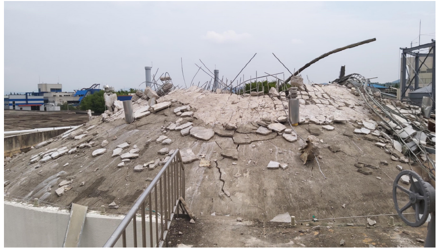
폭발 후 소화조 상부
