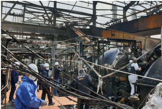
분해가스 폭발 사고 후 압축기실 현장
