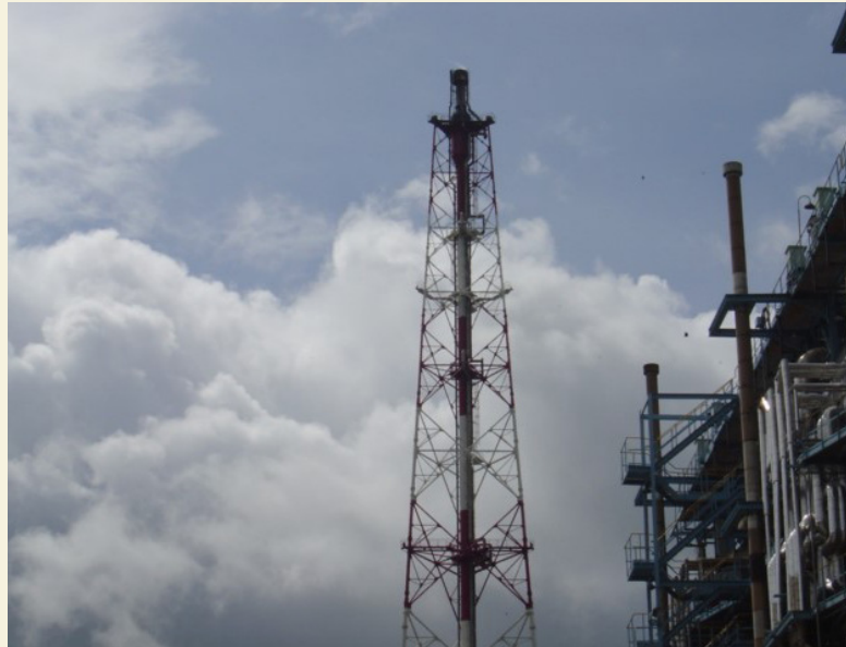
현장에 설치된 플레어스택의 모습
