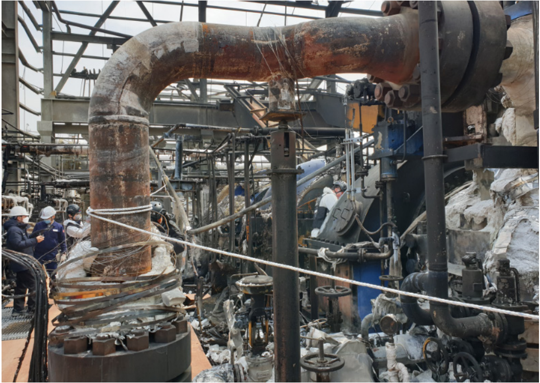
압축기동에 설치된 고압의 스팀(Steam) 배관
