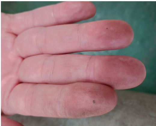
손가락에 묻어나온 산소 배관 내부 부스러기
