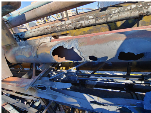
산소화재에 의한 손상된 질소 배관
