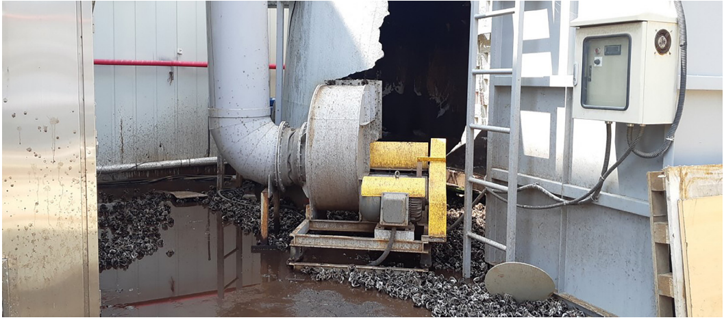
사고 당시 폭발로 파손된 세정탑(스크러버)
