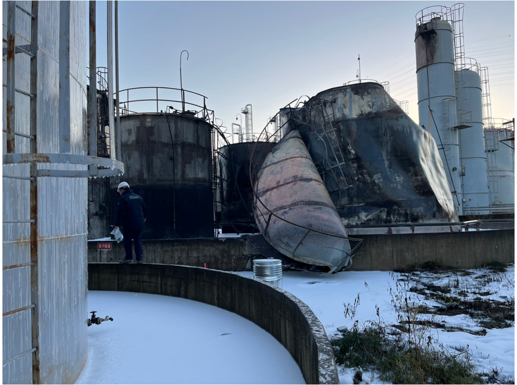
폭발로 인해 파손된 저장탱크
