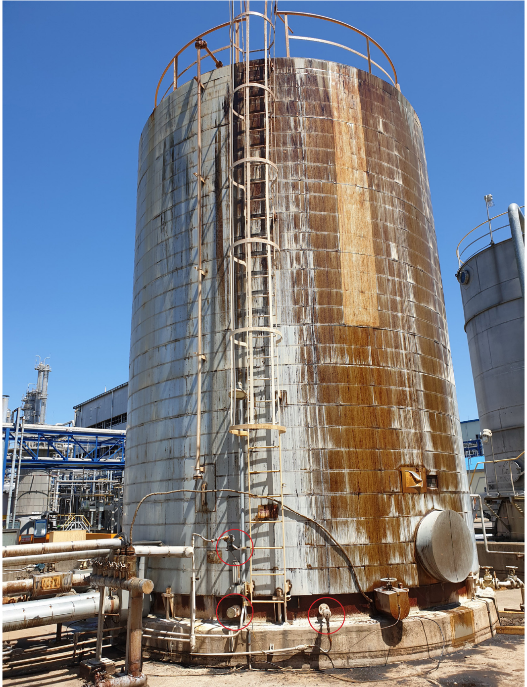
사고 발생 설비, 혼합잔사유 저장탱크(Mixed Residue Tank, FB.2)
