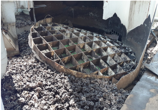
세정탑(스크러버) 내부 충진재 지지 철망과 충진재
