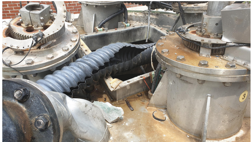
교반기 인양장치가 설치되어 있고, 소화조 상부의 맨홀이 개방되어 있는 현장 사진
