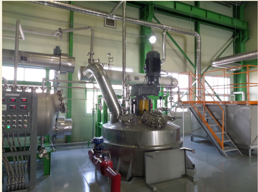
반응기 및 열교환기 등 부속설비가 설치된 현장 모습
