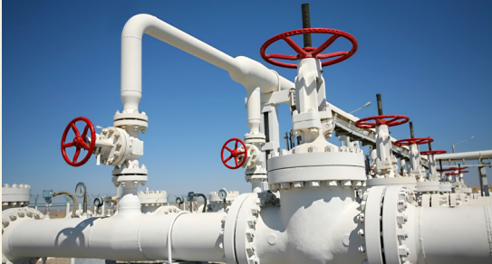
밸브가 설치된 배관 모습(게이트 밸브)
