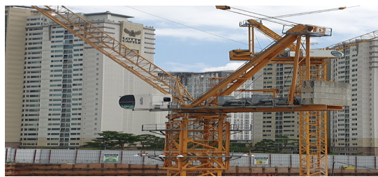
[ L-형 타워크레인 L型塔吊 ]
