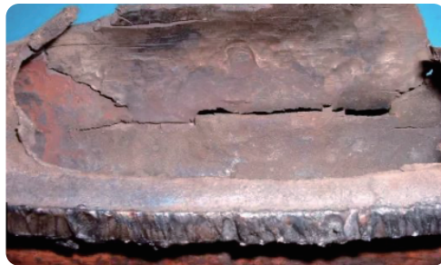
<그림 10> 고온 수소침식으로 보일러 튜브에 균열
