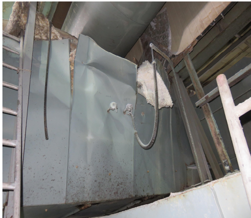
열풍기 흡·배기측 덕트 파손
