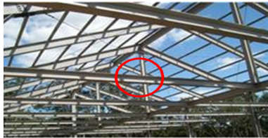
추락방호망 · 안전대걸이시설 미설치
