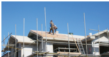
지붕작업 추락방지조치 미설치
