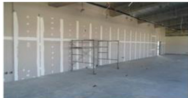
상부작업대 안전난간 미설치
