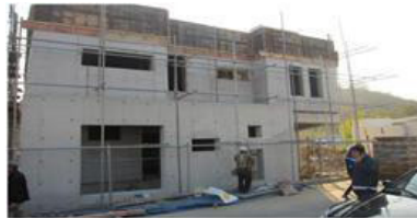
작업발판 · 안전난간 · 계단 미설치
