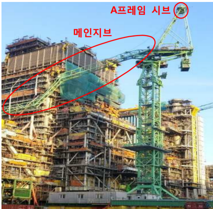
[그림 22] 총돌로 붕괴된 삼성중공업(주) 해양플랜트의 지브형크레인
