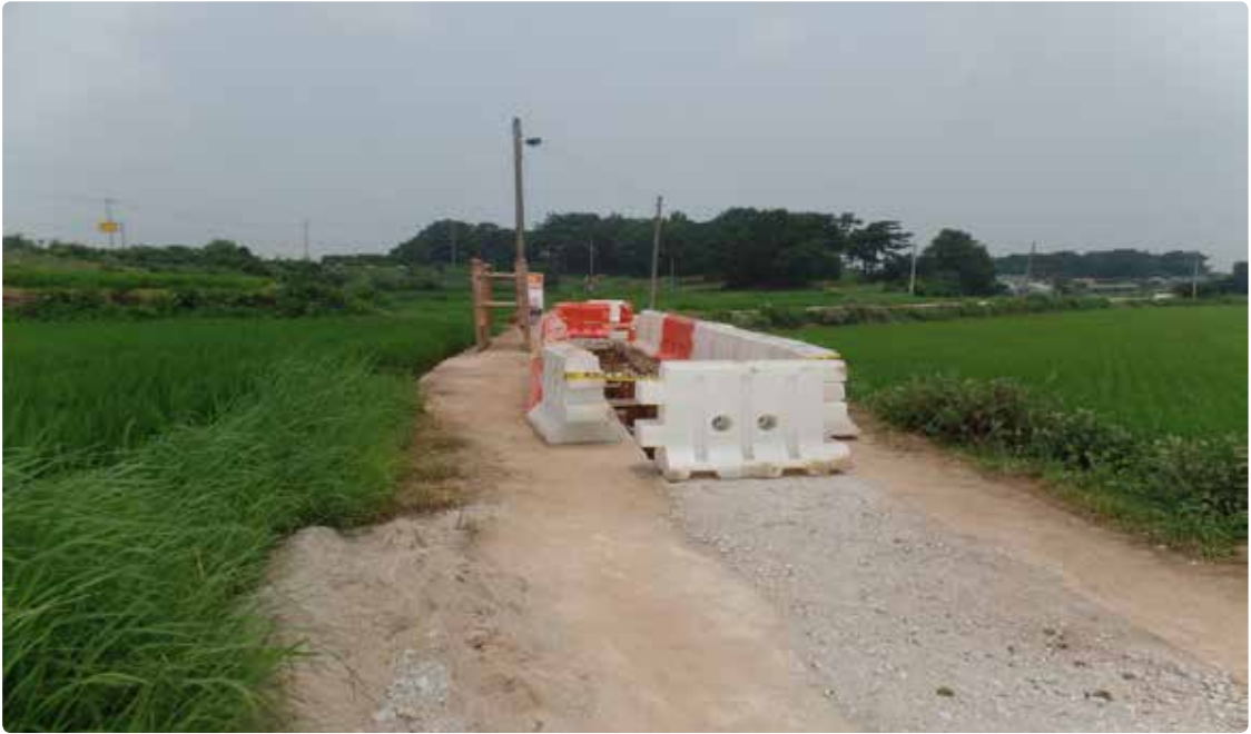
[사진1] 재해발생 현장 전경
