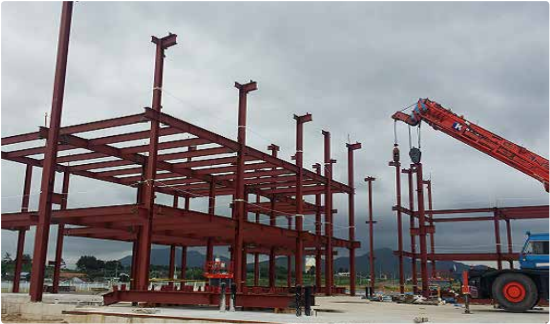
[사진1] 재해발생 현장 전경
