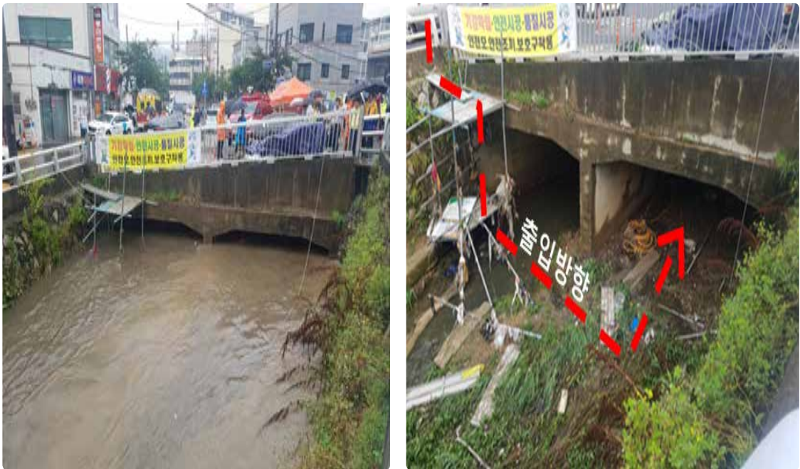
[사진2] 재해당시 출입구 전경(좌) / 재해 다음날 출입구 전경(우)
