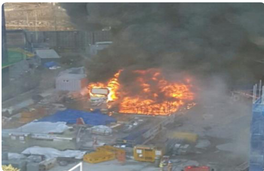
[사진1] 사고발생 당시 전경 사진
