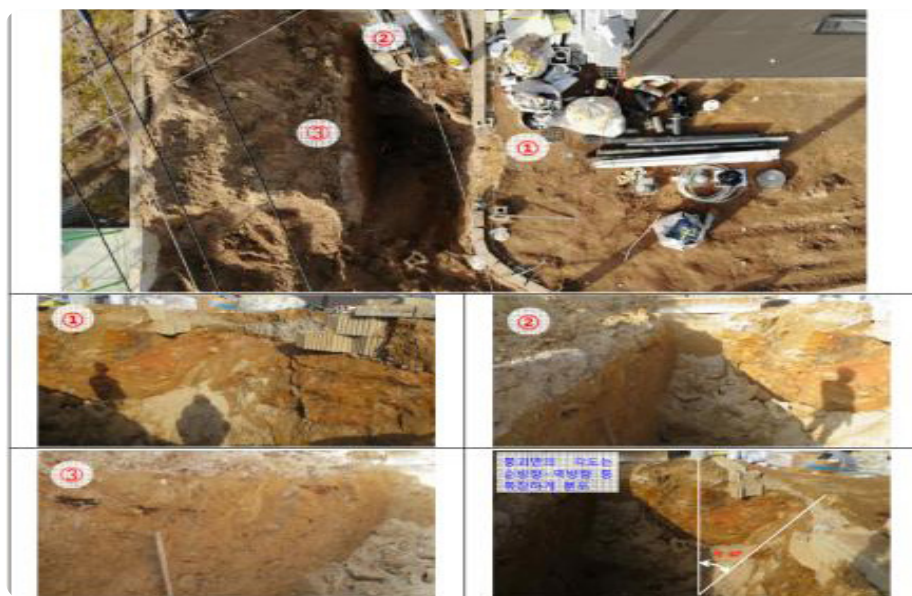
[사진 2] 붕괴현장 전경 및 붕괴 양상
