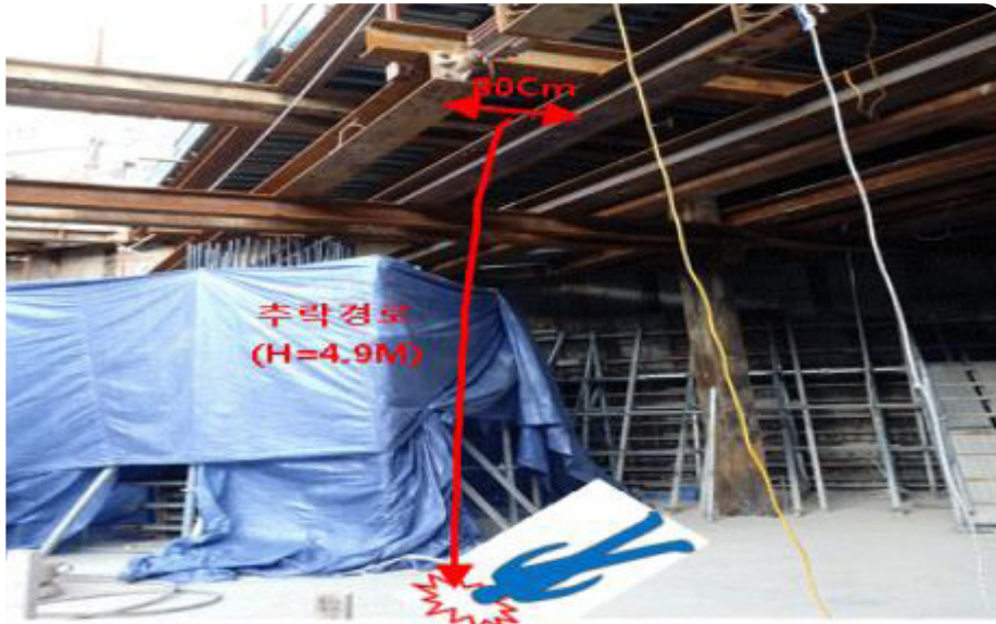
[사진1] 재해발생 현장전경
