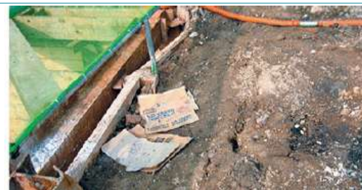
흙막이벽체 뒤채움 부실로 인한 균열
