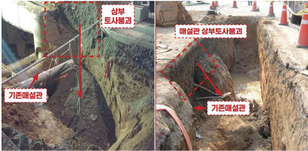
상부 되메움토 붕괴
