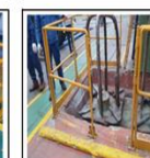
신선호기 안전난간 봉해 후 사용 (CHQ)
