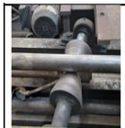
2롤 전베이어 롤러 베어링 교체 필요 (공무)
