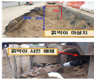
• 흙막이 미설치 또는 설치 불량
