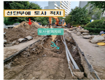
• 굴착 선단부 토사적치 또는 건설기계로 인한 하중증가
