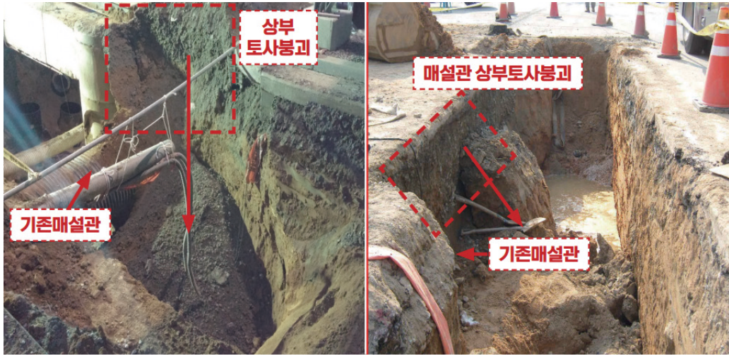
상부 되메움토 붕괴
