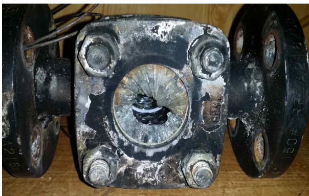
그림-5. 동파로 파손된 투시경
