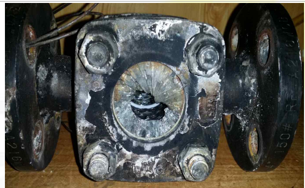
그림 1-2. 동파로 파손된 투시경(누출부위)
