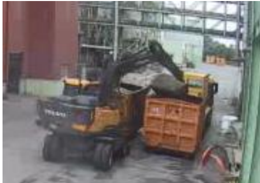
사고발생 작업(암롤박스 작업)
