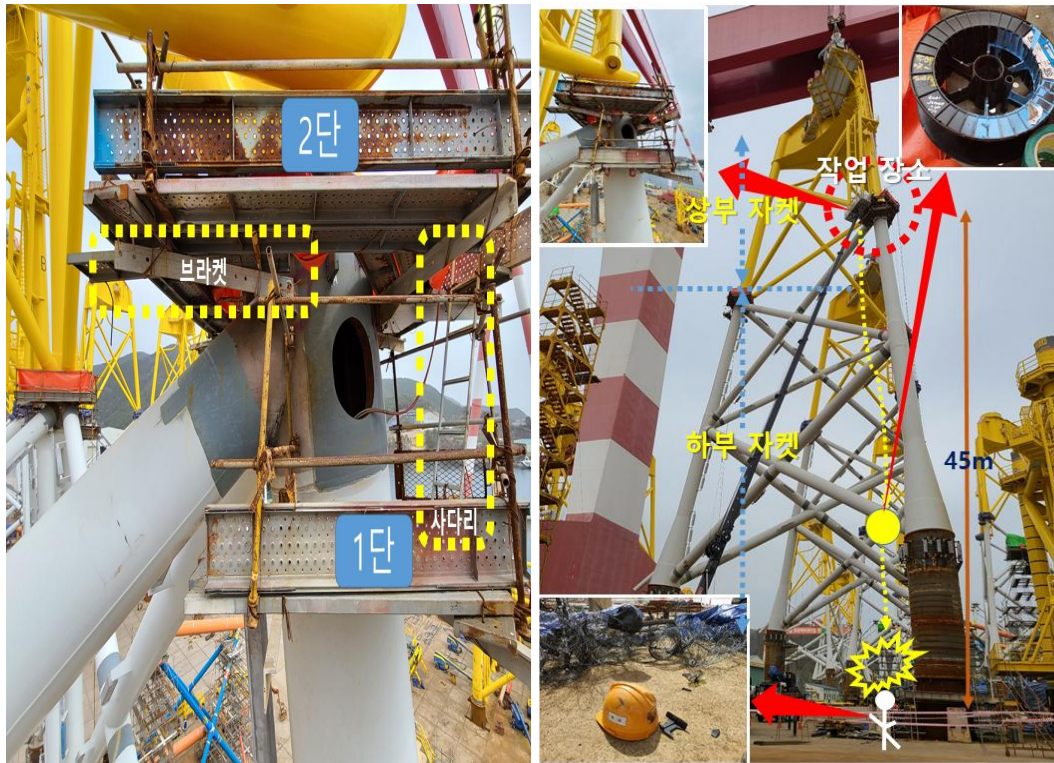
사고발생물체가 떨어진 작업장소(용접작업비계)
