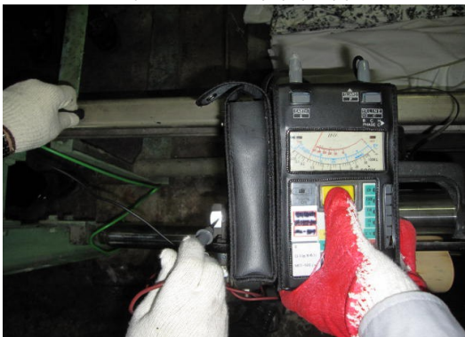
외함 접촉저항 측정(0.4MΩ)
