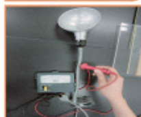
제어단자 및 이동식 조명등의 절연저항 측정
