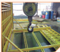
혹 해지장치 미설치 및 정격하중 미표시
