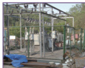
방호망 설치 상태 불량
