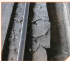
주행 레일 기초 파손
