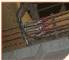
크레인 접지선 탈락
