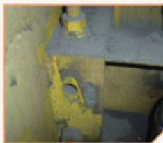
거더와새들 체결 볼트 탈락
