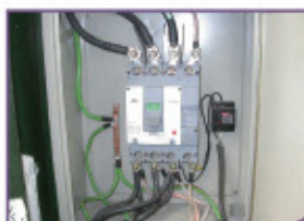
배선용 차단기 거꾸로 설치
