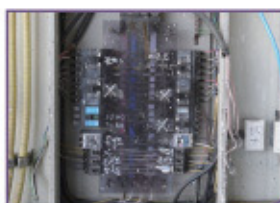
분전반 덮개 탈락
