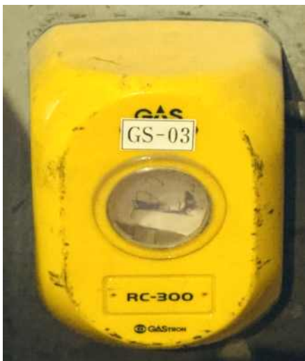
<현장에 설치된 가스감지기>
