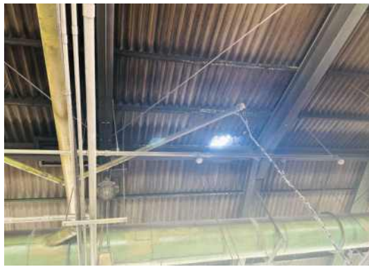
<사고설비 상부 지붕>
