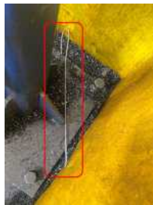
[사진10] 재해발생장소 바닥에 떨어진 끌개
