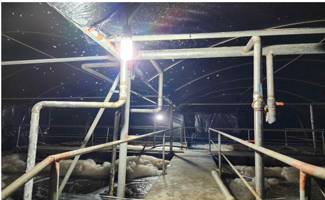
(사진9) 조명을 켜 상태에서 촬영한 사고 발생 수조 주변 전경
