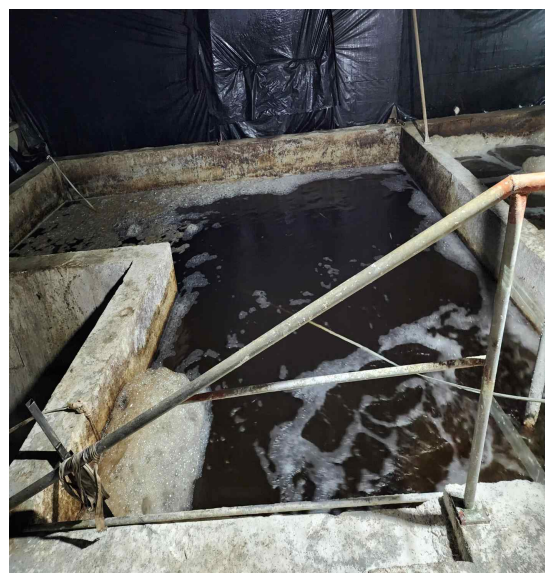
(사진4) 상부난간대 아주 낮게 설치된 부분
