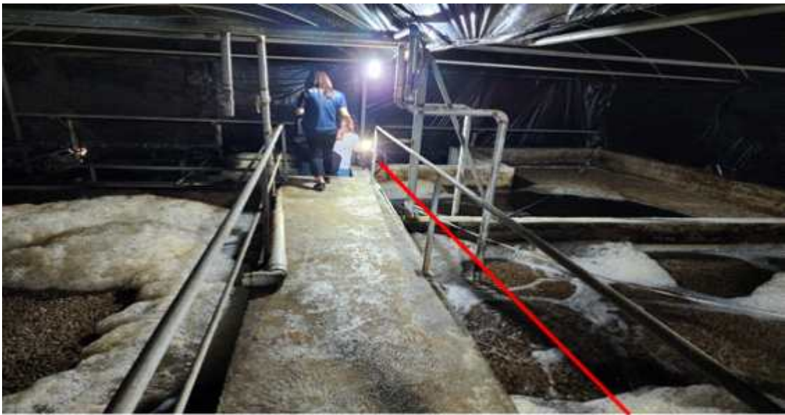
(사진2) 사고발생 수조(우측: 중간난간대가 설치되어 있지 않음)
