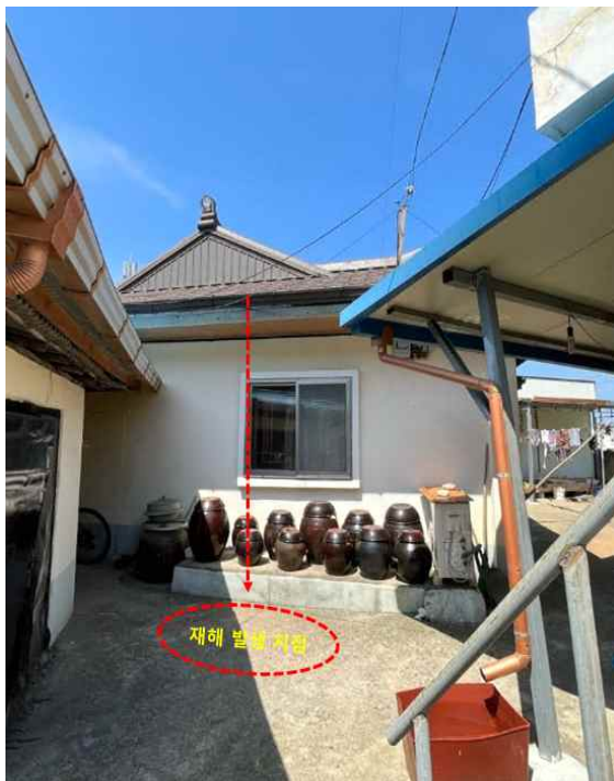
[사진1] 현장 전경(재해 발생 지점)
