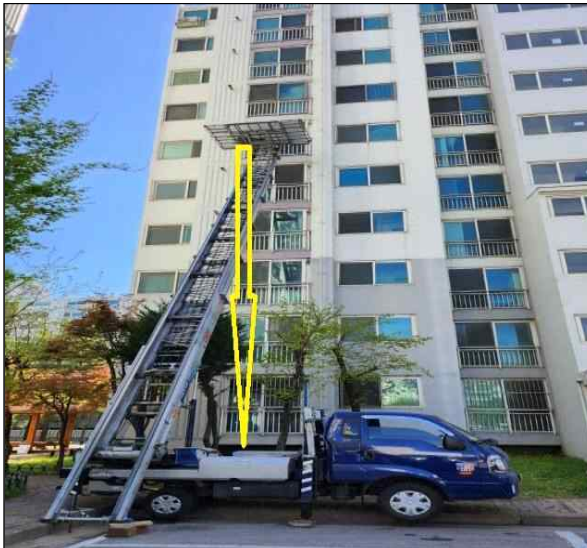
[사진1] 사고현장 전경(지상 높이 약 14.3m)
