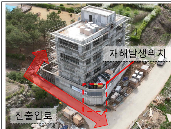
【사진 2】 재해 발생 건물
