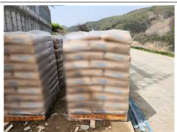
【사진 5】 옹벽 하부 적치된 자재
