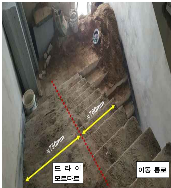
[사진 3] 사고당시 지상 2층 계단
