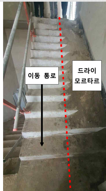
[사진 4] 조사당시 지상 2층 계단
