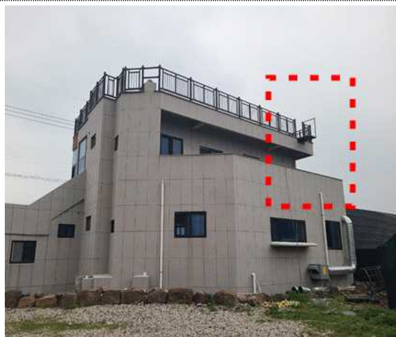
[사진2] 재해발생 당일 철재계단 제거된 상태
