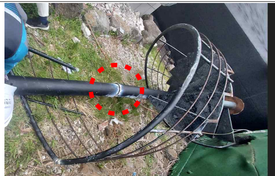
[사진8] 균형을 잃고 바닥으로 떨어진 나선형 계단 및 중앙기둥 용단부위(붉은원안)
