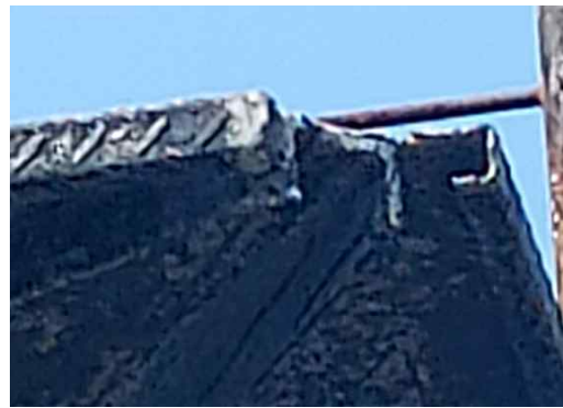
[사진6] 옥상층 계단참과 계단 중앙기둥 용단부위 상세
