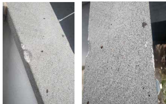
[사진10] 전도되는 계단과 파라펫이 부딪치며 파손된 흔적
