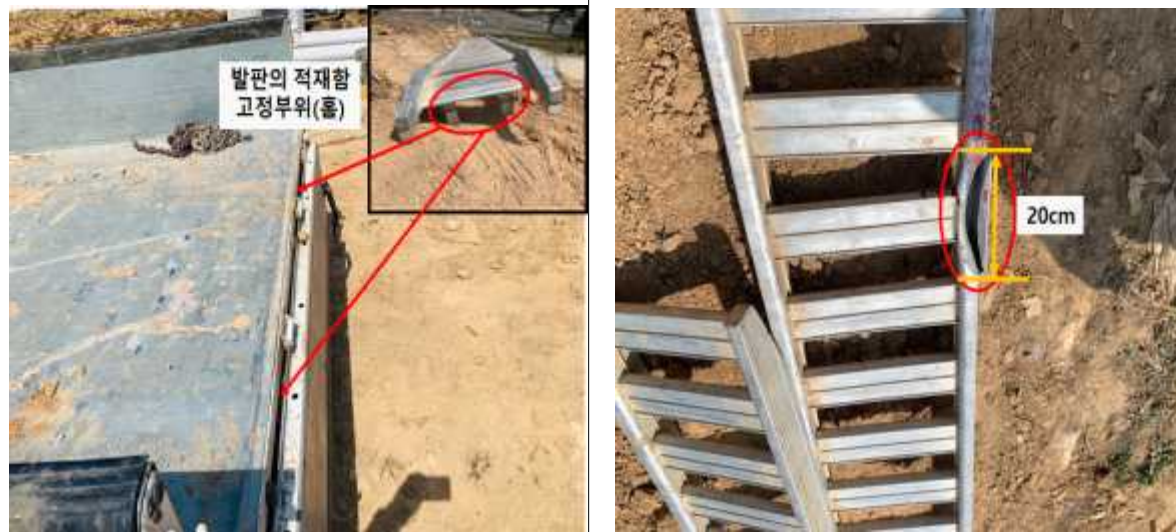
[사진 12] 적재함 가설대 고정부위 및 파손부위
