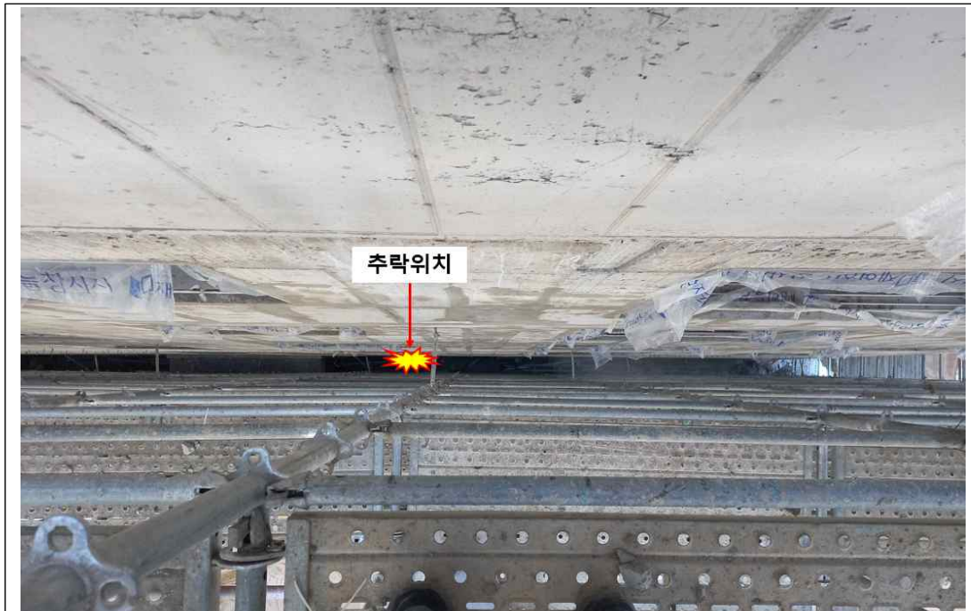
【사진6】 6층 비계작업 발판에서 바라본 건물 외벽과 비계 사이의 틈
