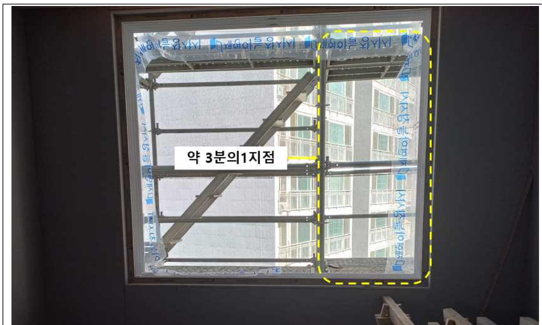
【사진5】 6층 비계 내측 안전난간이 설치되어 있지 않은 위치(사고이후 사진)
