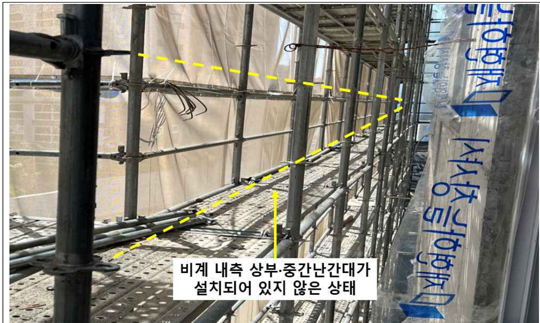
【사진4】 6층 창틀 밖 비계 난간 설치상태
