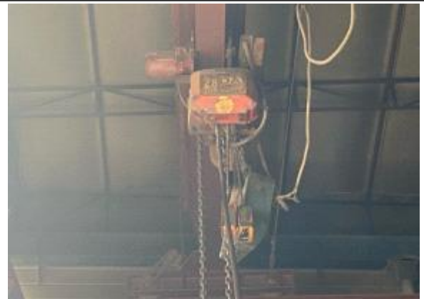
[사진 16] 2.8톤 천장주행크레인
