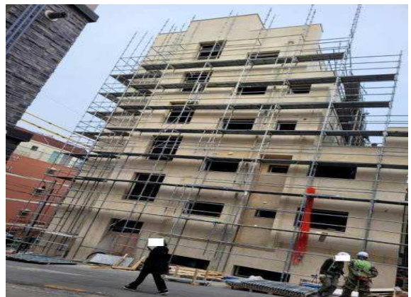
【사진 2】사고 발생 당시 현장 전경(우측면)
