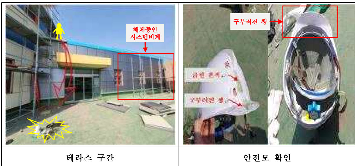
【참고 9】 추락지점 및 안전모 상태
