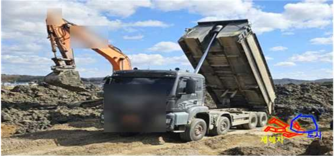
[재해발생 당시 재해자 발견 위치 및 상태(동료 근로자 면담)]
