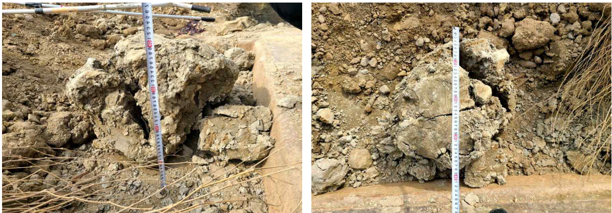
[재해자가 맞은 토사 * 중 일부(재해발생현장)]
