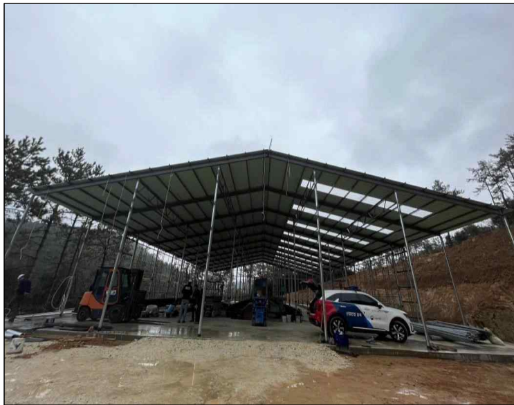
[사진1] 재해발생 현장 전경
