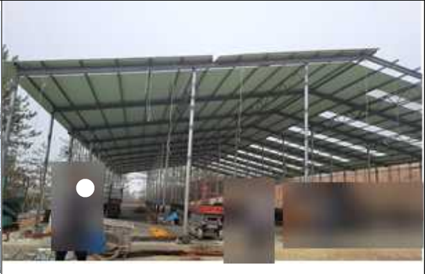
[사진 6] 재해 발생 당일 현장사진
