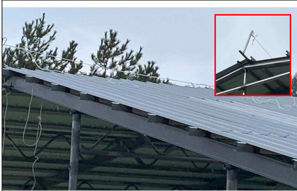
[사진 5] 재해 조사 당시 지붕 상부 안전대부착설비
