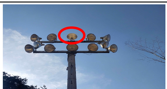
재해자가 설치한 조명등기구
