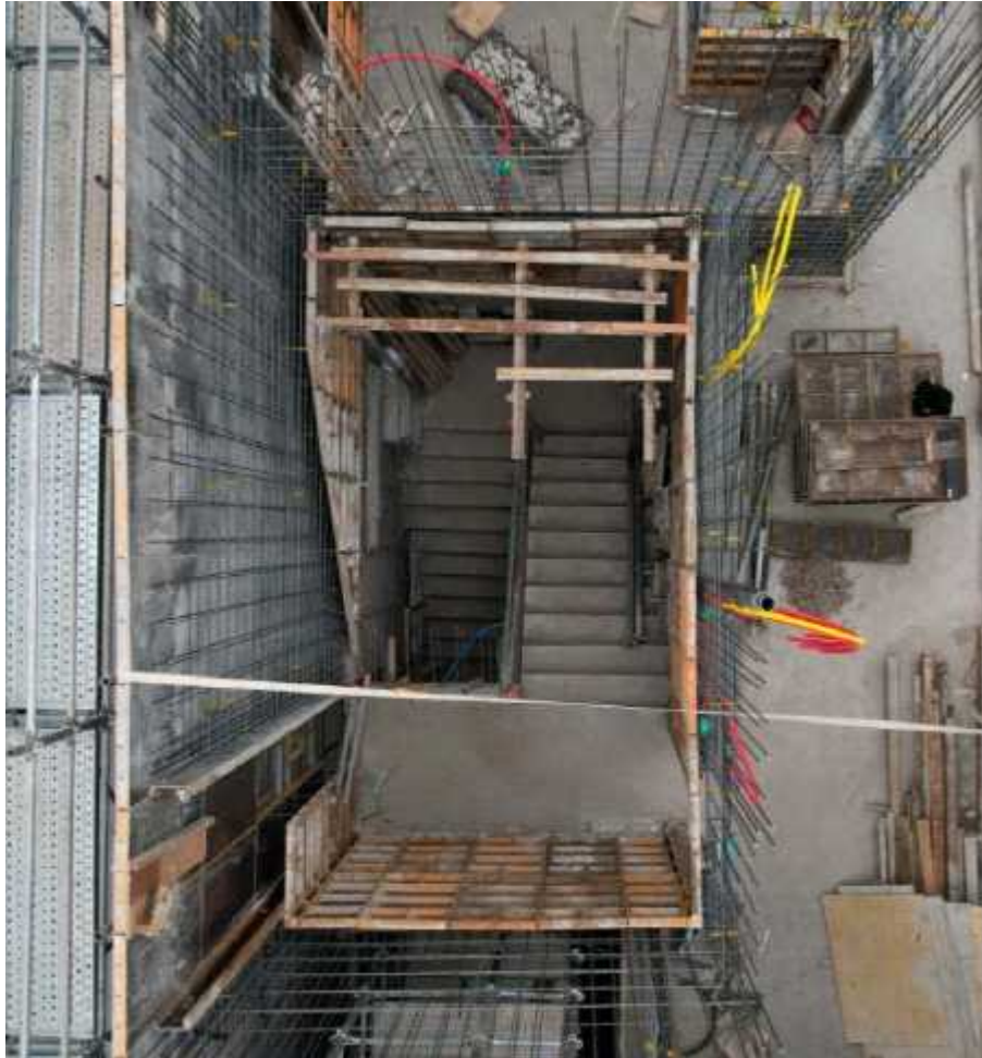
[사진 8] 작업장 주변 추락방지 시설 미설치 현황
