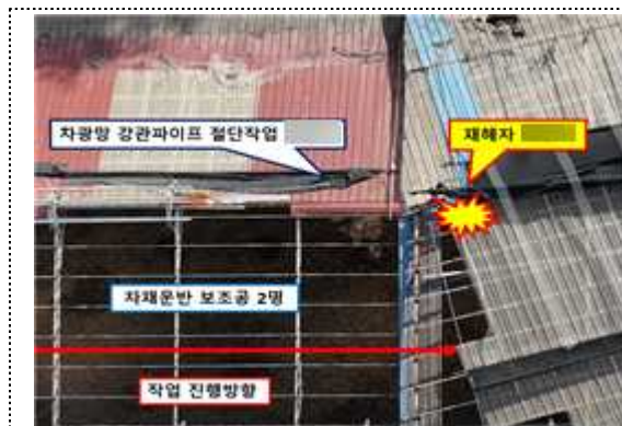
[사진 4] 재해발생 지붕 재해자 위치
