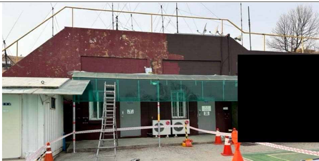
【사진 1. 사고현장 전경】
