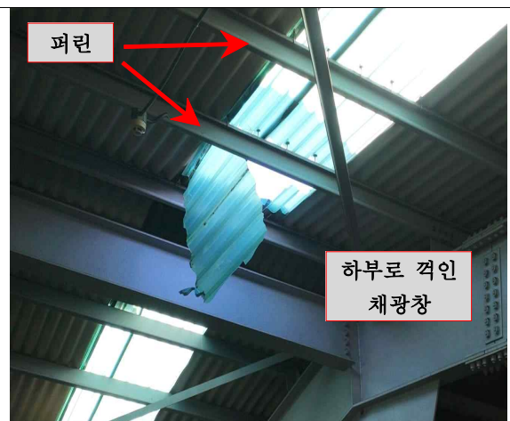
[사진14] 추락지점 하부 전경(공장내부)
