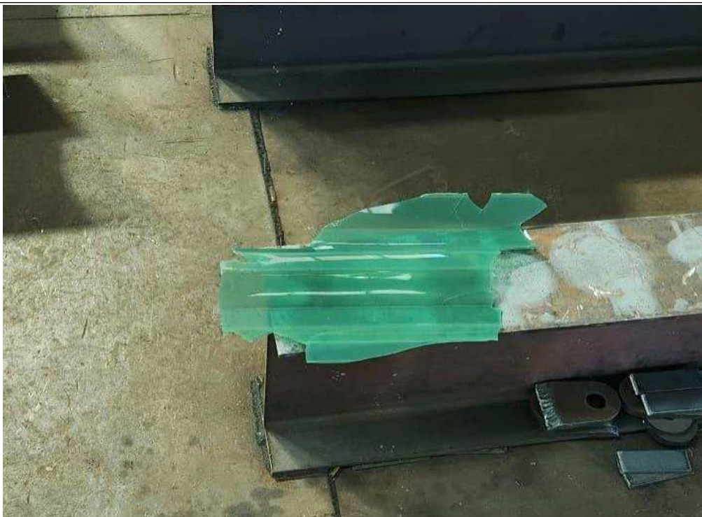
[사진16] 부서진 채광창 잔해 (준공 후 13년 경과되어 변색됨)
