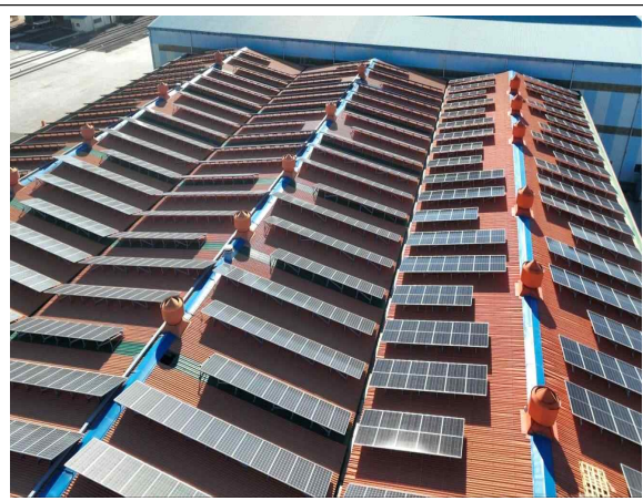
[사진3] 구조물 위 설치된 태양광패널
