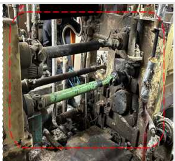
재해 당시의 동력전달부 상태
