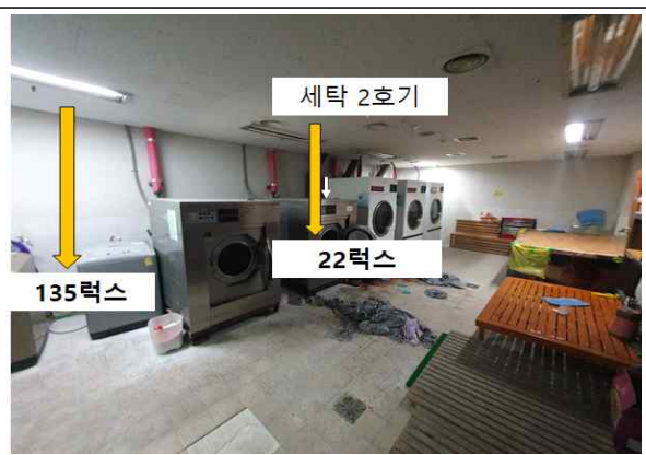
[세탁실 천장 조명 설치 상태]
