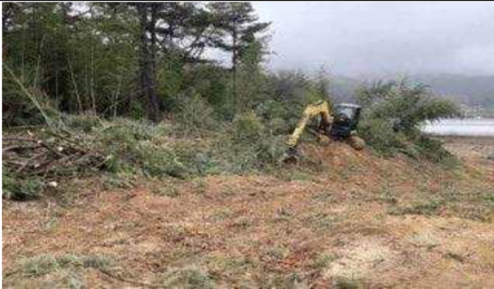
(사진1) 사고현장 전경
