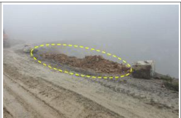
재해발생 위치 추락방지 조치상태(22.1.13)
