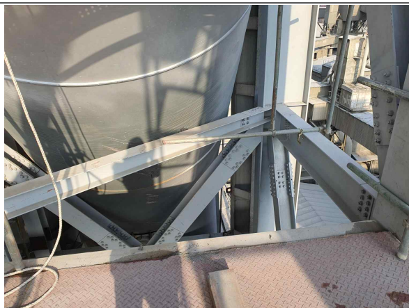
[사진 6] 재해발생 장소 개구부 상태
