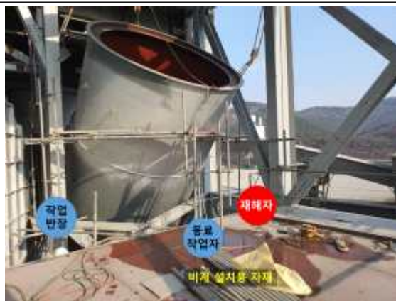
[사진 4] 재해발생당시 작업자 위치
