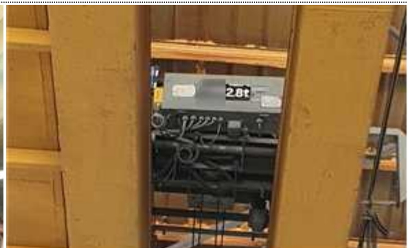
[사진 13] 재해당시 사용한 크레인(2.8ton) 호이스트
